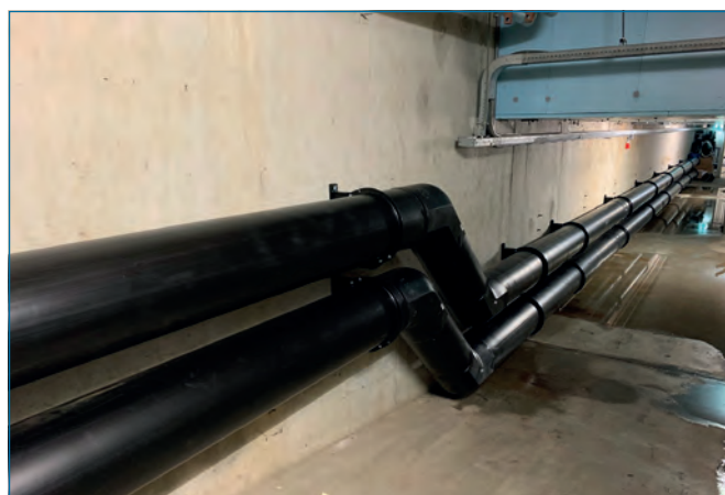
COOL-FIT 4.0 klimaatleidingen in een ziekenhuis
