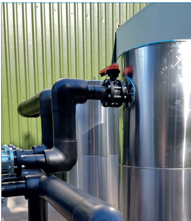
COOL-FIT 4.0 aansluiting op buffervat met vlinderklep
