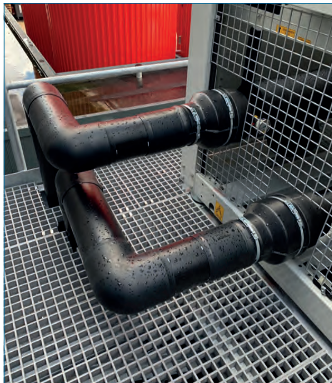
COOL-FIT 4.0 aansluiting op chiller
