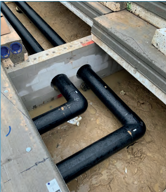
COOL-FIT 4.0 in kruipruimte
